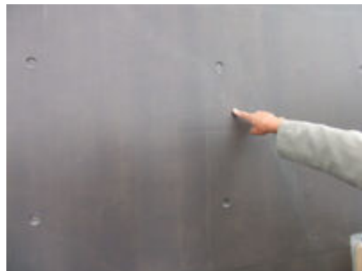
フライタワー壁面のクラック箇所
